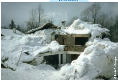
Chalet détruit par une avalanche
