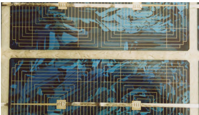
Installation 1995 : Altération de l'EVA et/ou de l'émaillage entre cellules qui donne un aspect irrégulier type « moirure ou équivalent »
