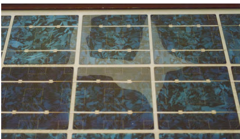
Installation 1994 : Délaminage conséquent formant grossièrement un U (longueur développée de 30cm environ)
