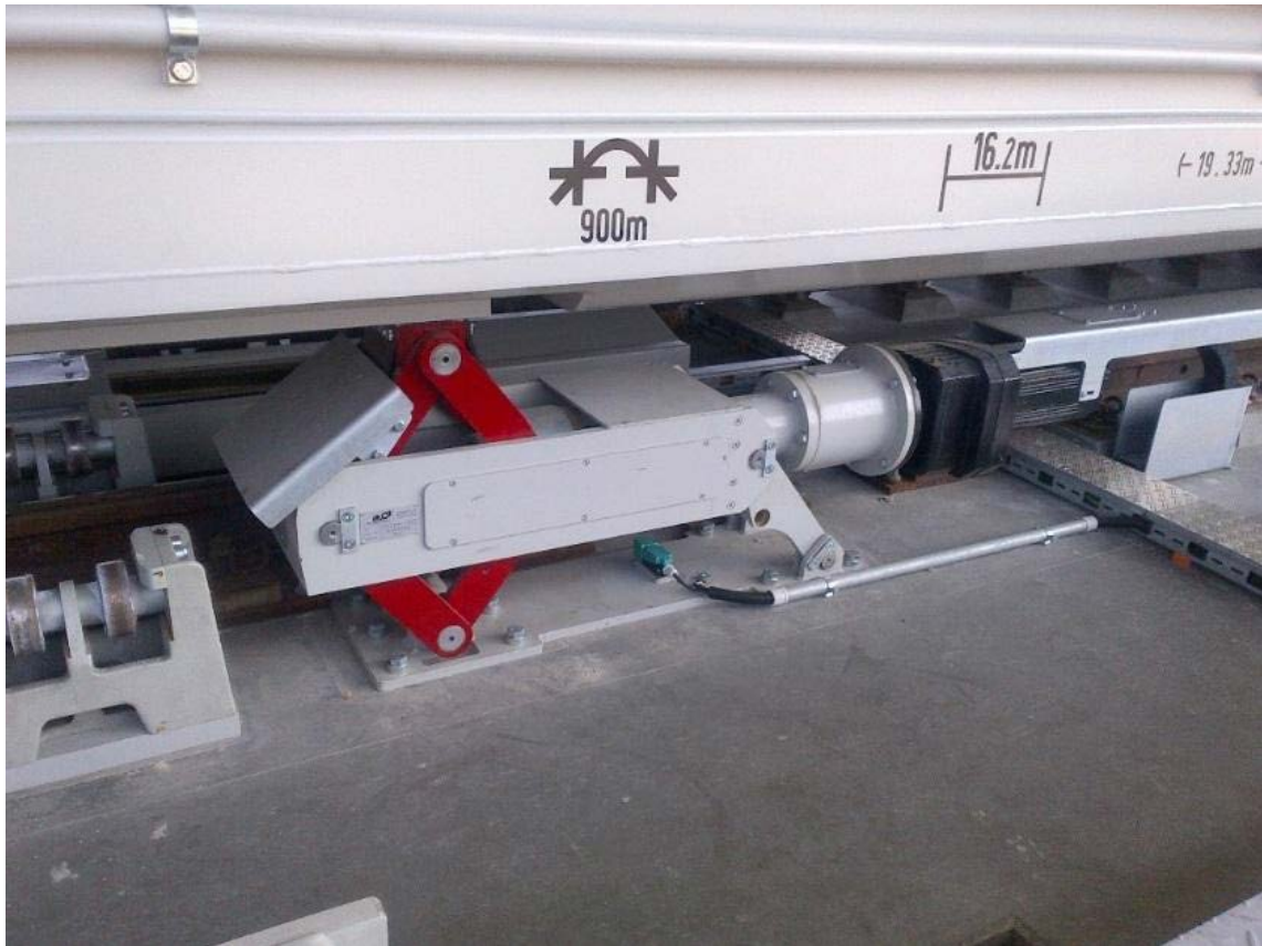
Figura 3-15 Dispositivo de elevación "GMHV" en la zona de la plataforma
