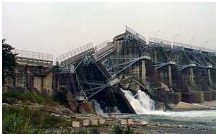
Figure 3-4 - Barrage de Shih-Kang après le séisme Chi Chi (Taïwan). – rupture au droit de la faille
