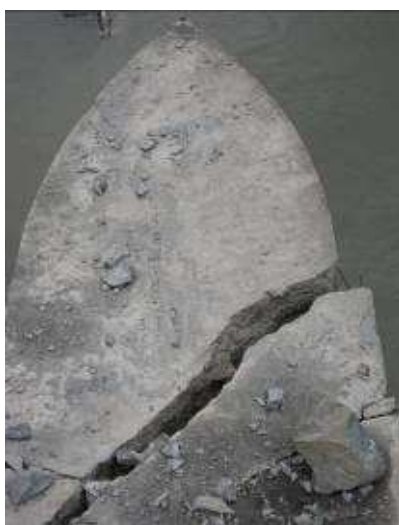
Figure 3-7 - Nez de pile d'un barrage en rivière suite à des chutes de pierres
