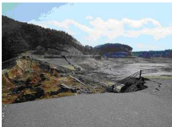
Figure 3-2 – Rupture du barrage de Fujinuma (séisme de Tohoku mars 2011)
