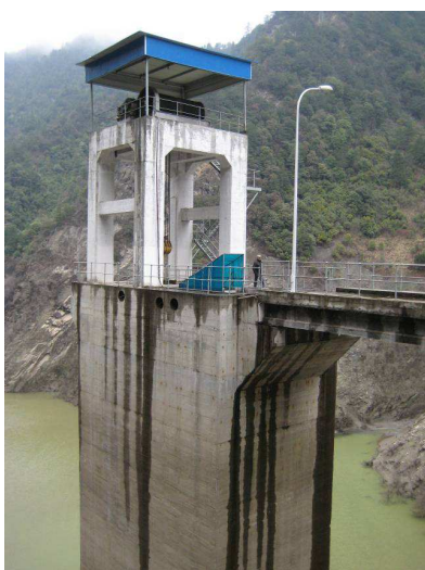
Figure 3-6 - Fissures sur le portique de la tour de prise d'eau de Shapai
