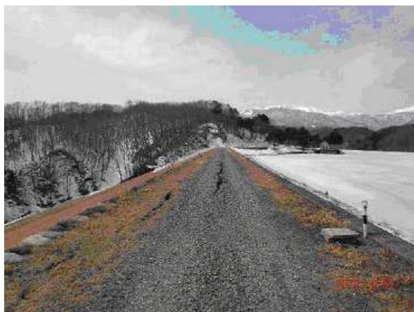
Figure 3-3 - Fissures longitudinales sur le barrage de Nishigo (séisme de Tohoku mars 2011)
