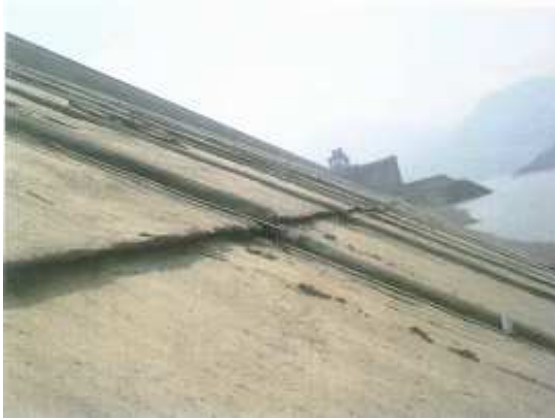
Figure 8-4 – Séisme du Wenchuan - parement amont du barrage de Zipingpu (photo M. Wieland)
