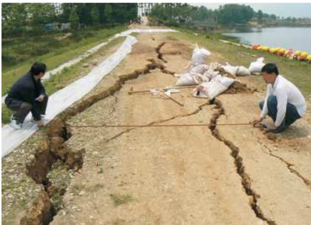
Figure 8-5 – Séisme de Wenchuan (photo M. Wieland)
