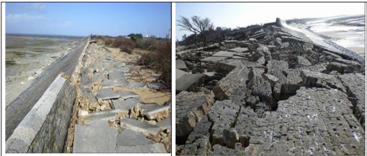
Figure 2.28 – Digue Ouest de Saint Clément des Baleines : Effondrement de la dalle de crête (photo a) qui peut se poursuivre par un effondrement de la protection en maçonnerie du talus jusqu'à formation d'une brèche (photo b) – Source DDTM 17.
