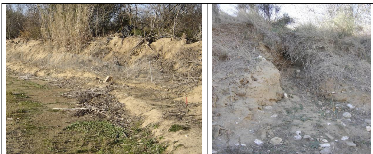
Figure 2.33 – Digue du Réart : Erosion du talus coté cours d'eau et présence de terriers coté ZP – Source Cerema.
