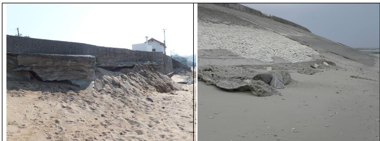
Figure 2.25 – a- Sous-cavage de la digue d'Erromardie -estran principalement sableux- Source Cerema ;b- Digue de Saint Clément des Baleines : Abrasion du perré et baisse du "platier" calcaire nécessitant un enduit sur le parement et des recharges en pied de talus - Source Irstea.
