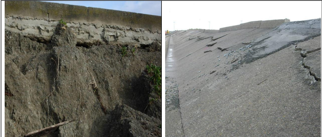
Figure 2.27 – Digue du Bouin : Erosion du remblai par surverse (photo a côté ZP) jusqu'à apparition de vides sous les plaques qui s'affaissent (photo b côté mer) – Source Irstea.
