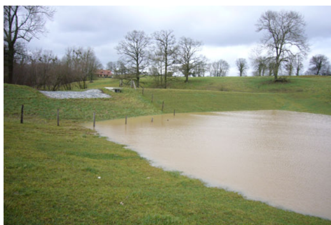
Illustration 21 : Bassin de rétention en charge – SMBVAS
