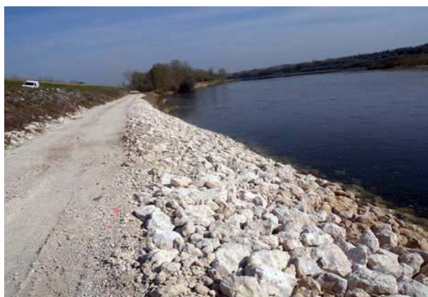
Illustration 48 : Enrochements – DREAL centre
