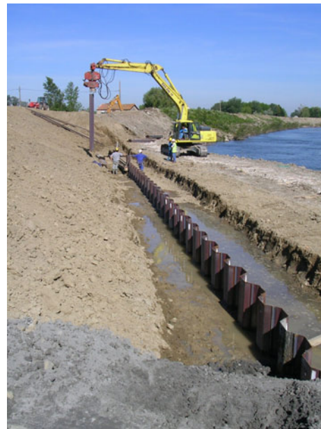
Illustration 61 : Pied de talus en palplanches – Symadrem
