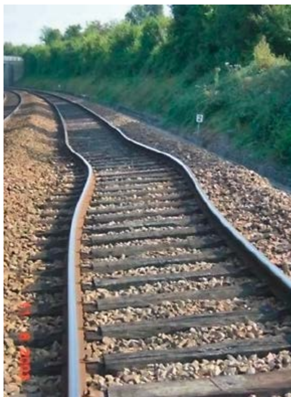
Figure C 40 : Déformation de la voie sous l'effet de fortes chaleurs.
